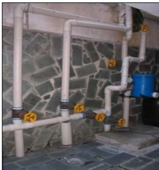
Figura 19: Sistema de captação de águas pluviais.
