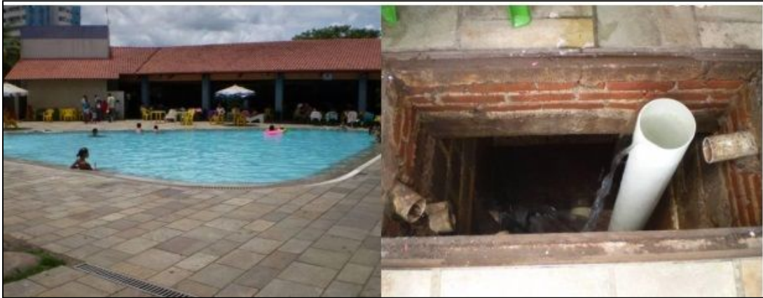
Figura 18: Piscina termal e caixa de descarte de águas termais destinadas para reutilização como recarga artificial para os aquíferos termais da região de Caldas Novas-GO.
