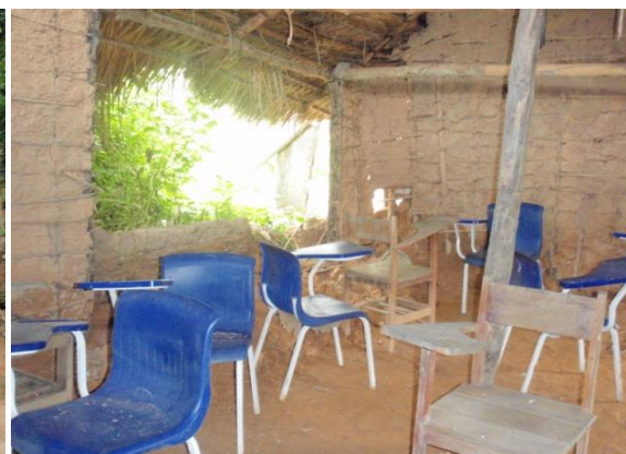
Fotografia: Selma Azevedo Foto 4: Sala de aula sem parte da parede/2012
