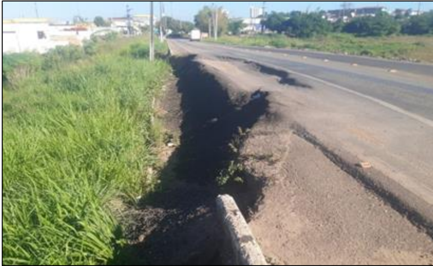
Figura 4 - Trecho da BR 230 com área deslizada
