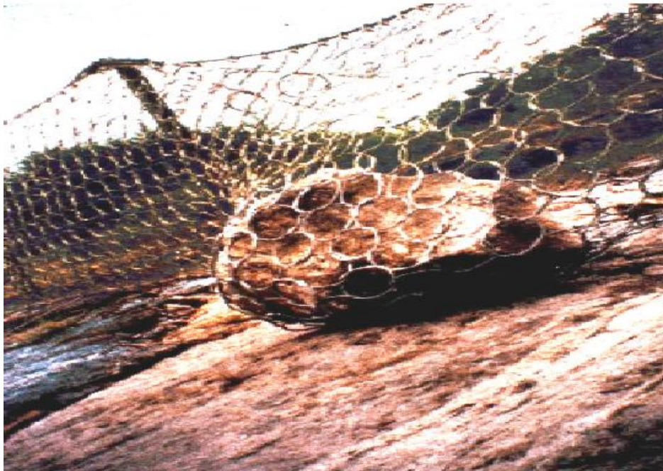
Figura 03 – Rede de proteção contra desmoronamento.
