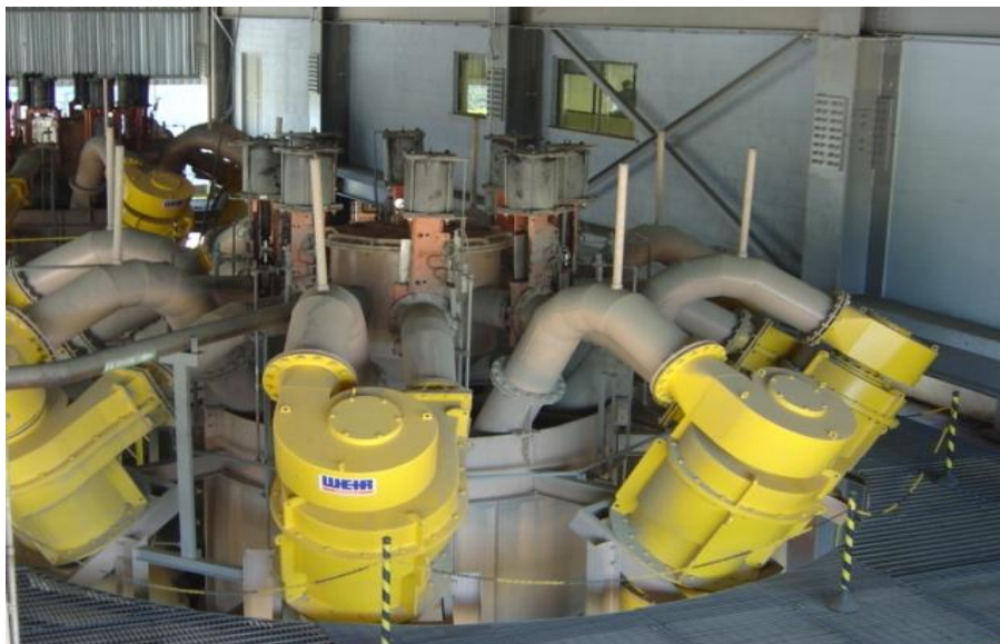
Figura 9. Bateria de hidrociclones presente na usina de beneficiamento.
