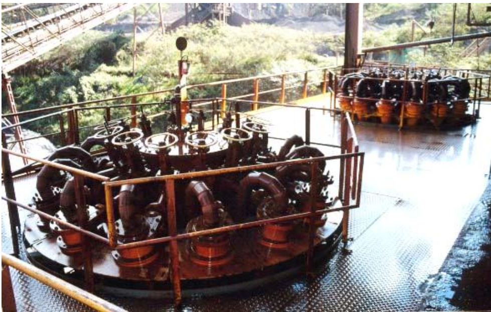
Figura 5 - Baterias de hidrociclones Fonte: VALE (2007)
