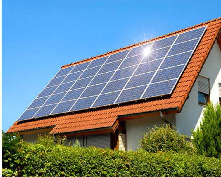
Figura 5 - Sistema fotovoltaico residencial
