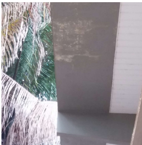
Figura 34 - Manchas na face inferior da laje.
