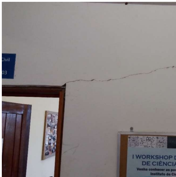
Figura 28 - Fissura inclinada em canto de porta.
