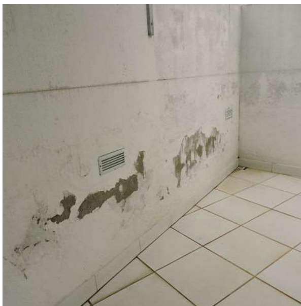
Figura 9 - Deslocamento do revestimento argamassado.
