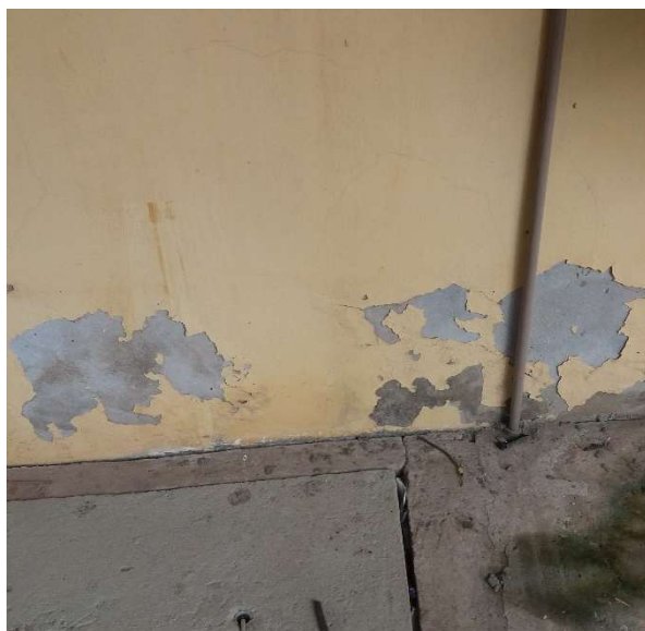
Figura 42 - Desplacamento de revestimento.
