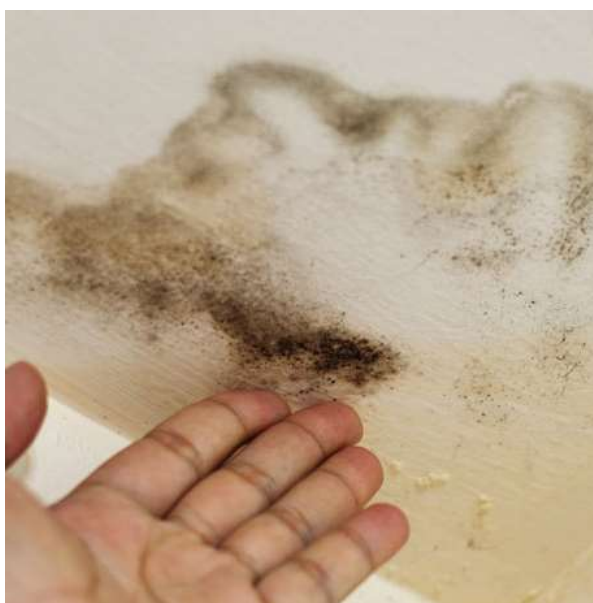
Figura 10 - Mancha decorrente de umidade
