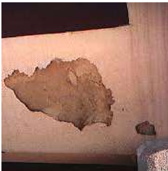
Figura 12 - Desplacamento do revestimento argamassado.
