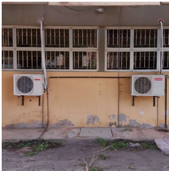
Figura 32 - Desplacamento de revestimento.
