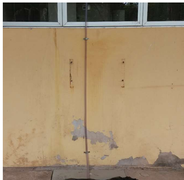
Figura 43 - Desplacamento de revestimento.
