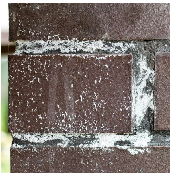
Figura 11 - Formação de eflorescência no concreto.
