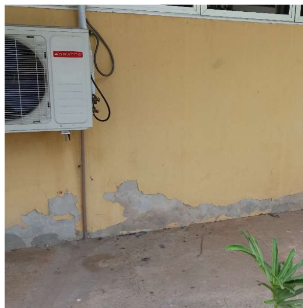
Figura 33 - Desplacamento de revestimento.
