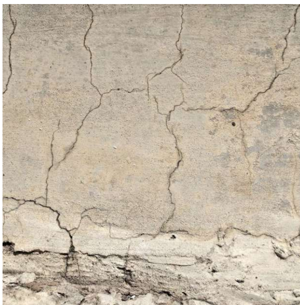
Figura 5 - Fissuras ocasionadas pela retração do concreto.
