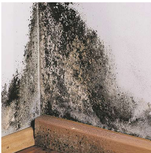
Figura 8 - Bolor negro no revestimento da parede.
