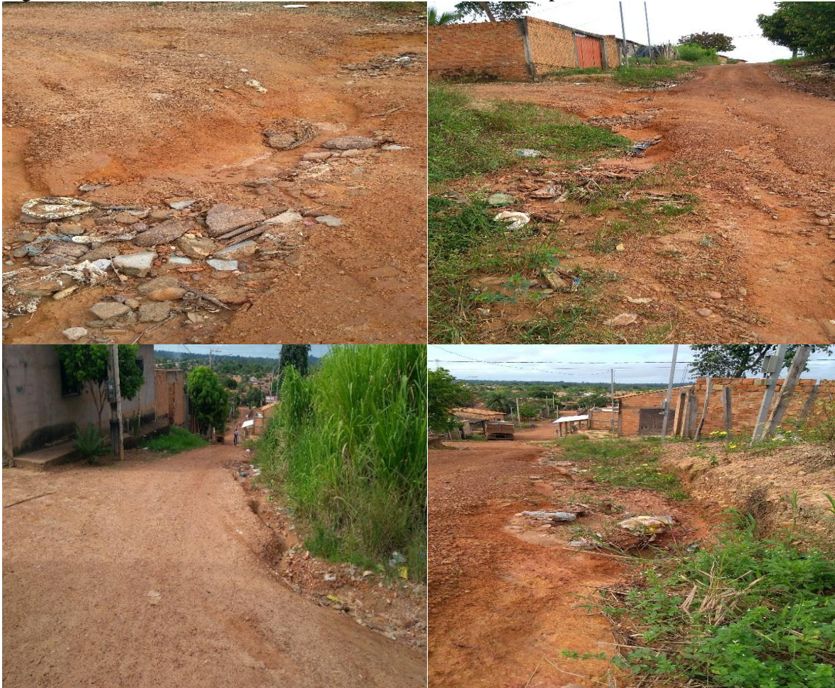
Figura 16. Processos erosivos decorrentes do escoamento superficial bairro Infraero
